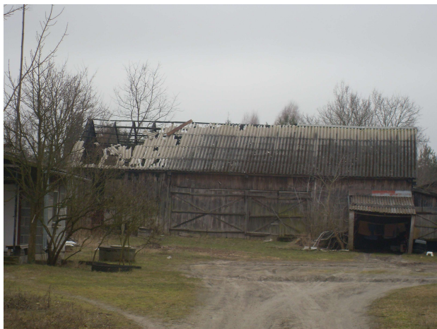
Fot. M. Stankiewicz, Uszkodzone płyty eternitowe
