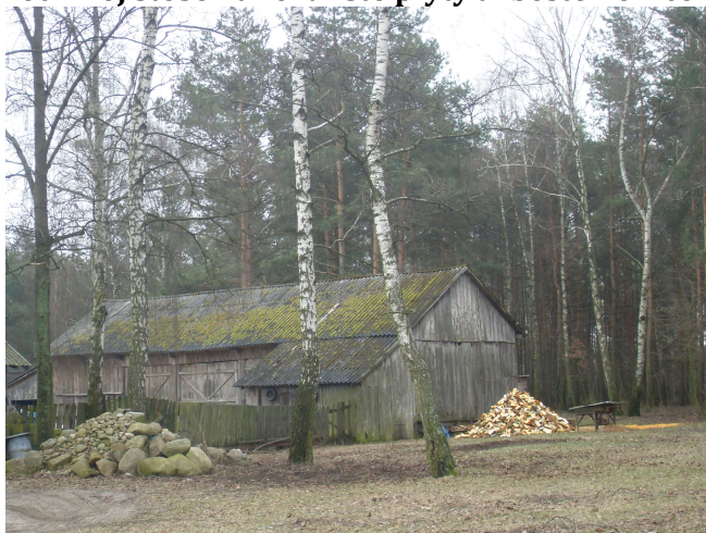
Fot. M. Stankiewicz, faliste płyty azbestowo – cementowe
