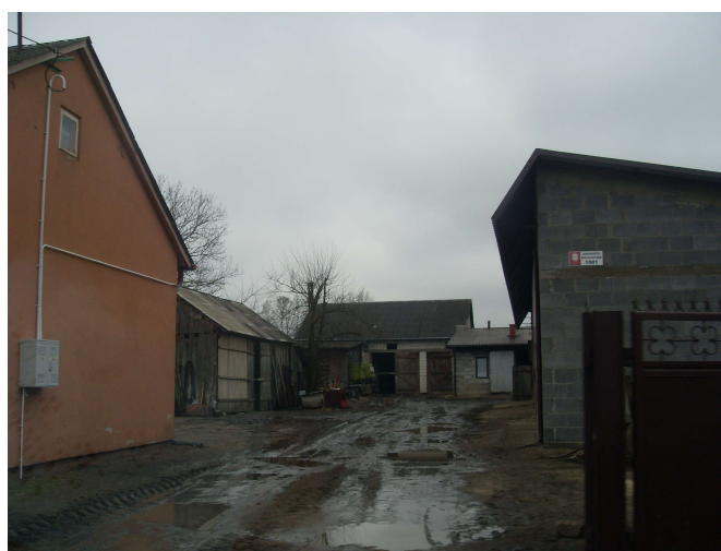
Fot. M. Stankiewicz, faliste płyty azbestowo – cementowe
