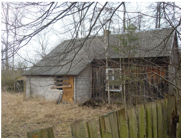
Fot. M. Stankiewicz, Uszkodzone płyty eternitowe
