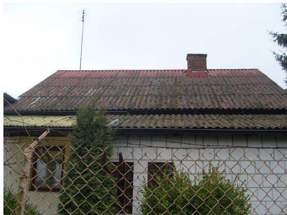
Fot. M. Stankiewicz, Budynki mieszkalne pokryte płytami z eternitu
